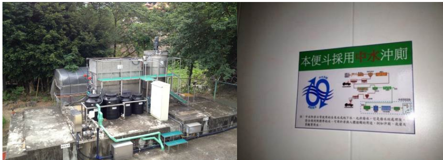
中水回收設施處理及設施實景
